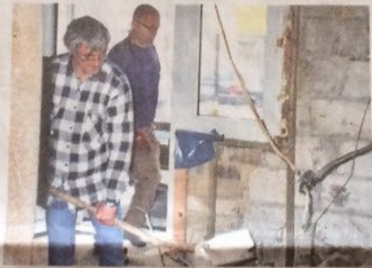
Der Umbau des Tafelladens an der Recklinghäuser Straße war harte Arbeit. REPRO WOLTER
